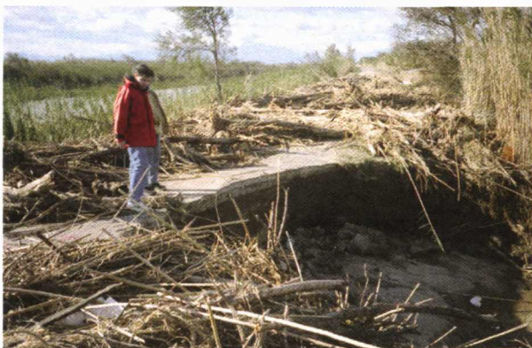
Photo 3.1a (source DDE 66) – Dégâts dus aux surverses sur les digues de l'Agly, suite à la crue des 12-13/11/1999 : importante loupe d'érosion dans le talus, laisses de crue sur le couronnement.
