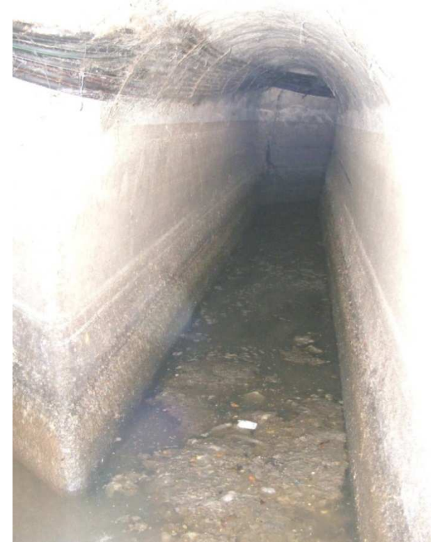
Dépôt occupant une bonne partie de la section de temps sec
