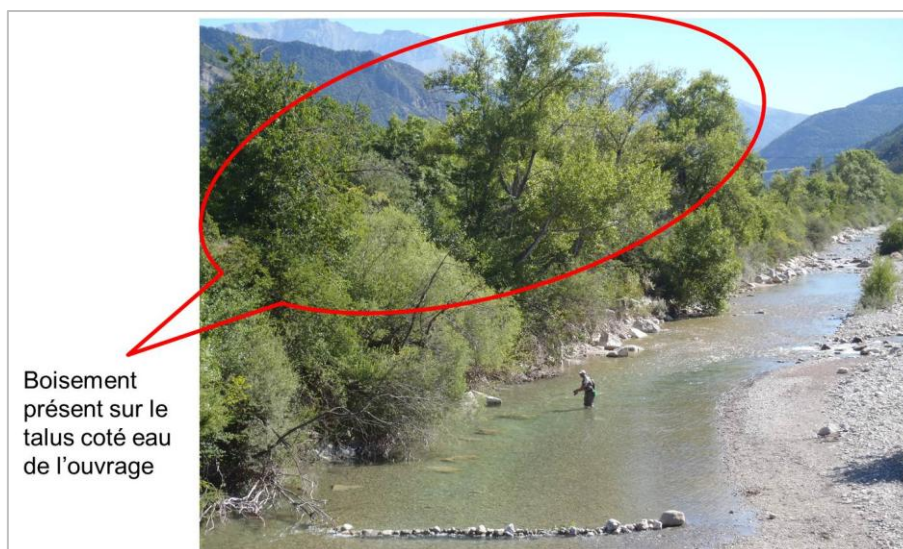
Figure 65. Vue du tronçon n°1 du talus coté rivière soumis à la présence d'une végétation arborescente de la digue de protection contre les inondations de Veynes (05) (photo : Bambara G., 2012)
