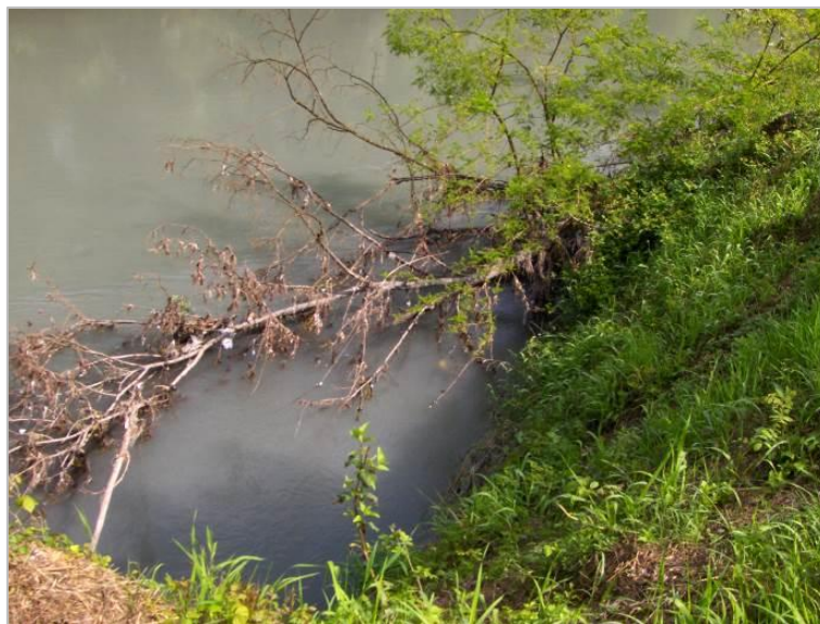
Figure 17. Affouillement du pied d'une digue par les courants tourbillonnaires derrière un arbre tombé (photo : Zanetti C.)
