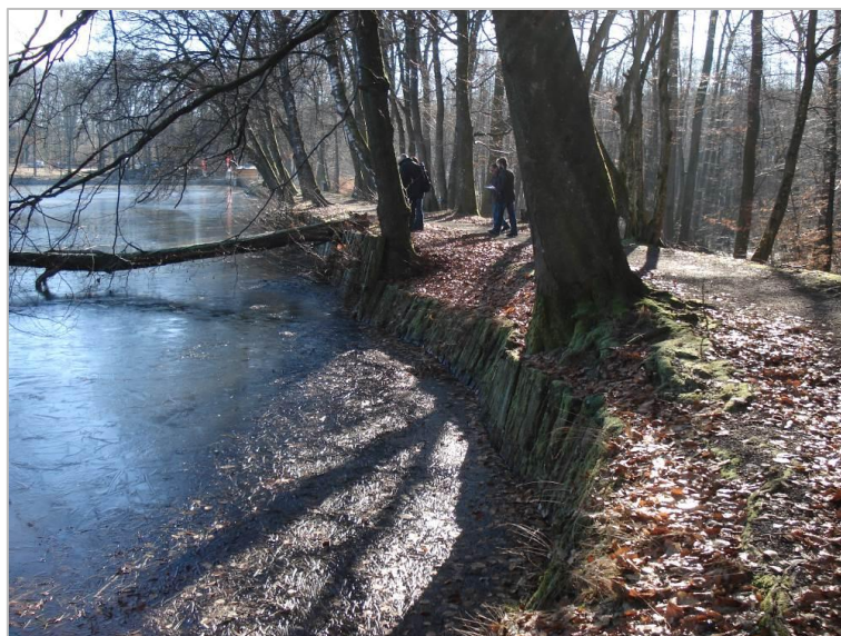
Figure 59. Illustration d'arbres de haute tige, au port dangereusement penché, se développant au-dessus du niveau normal des eaux d'un petit barrage d'étang et ayant tendance à déstructurer la protection anti-batillage, ici par pieux-bois (photo : Mériaux P.)
