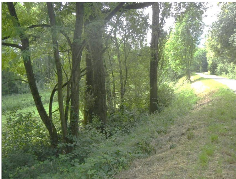
Figure 11. Digue en remblai de protection contre les inondations en Isère (38) soumise à la présence de végétation arborescente (photo : Bambara G.)
