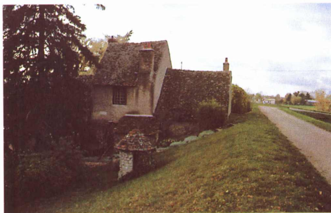
Photo 13 : Maison encastrée dans le talus côté Loire sur la levée du Val de Bou (45) - repère de crue en façade.
