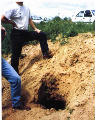
Photo 15 : Débouché de terrier de blaireau en sommet du talus côté val de la levée d'Espagne.
