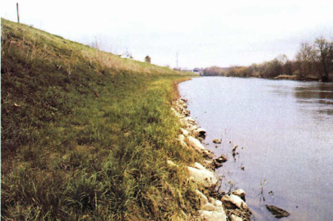
Photo 12 : Talus côté rivière renforcé sur la levée rive droite du Cher à Savonnières(37) - vue de détail du talus reprofilé et des enrochements affleurant en pied.
