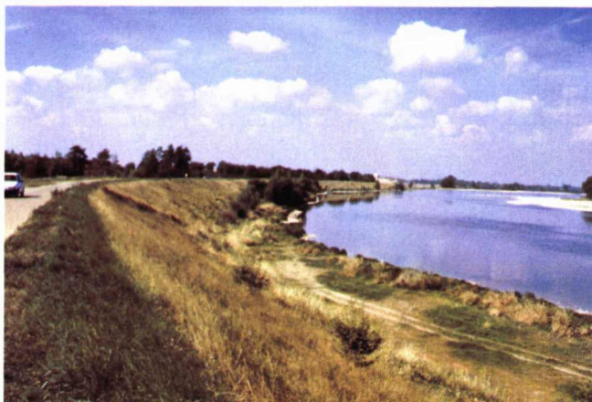
Photo 2 : Levée rive gauche de la Loire en amont d'Orléans (45) - profil large, voie de circulation en crête, proximité et courbe du lit mineur
