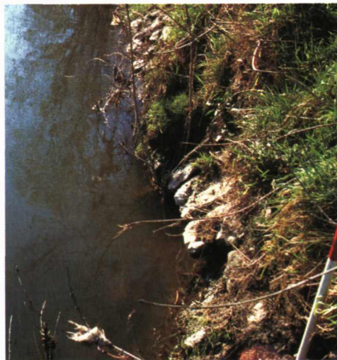
Photo 8 : affleurement d'un ancien perré de protection sur la berge de la levée rive droite du Cher à Savonnières (37) - vue de détail de l'affouillement et du sous-cavage en pied.
