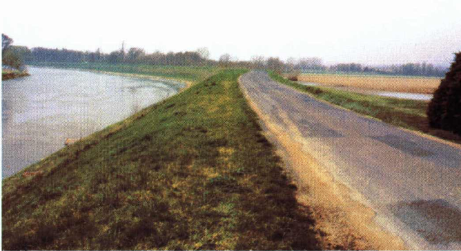
Photo 11 : Talus côté rivière renforcé sur la levée rive droite du Cher à Savonnières(37) - vue générale.
