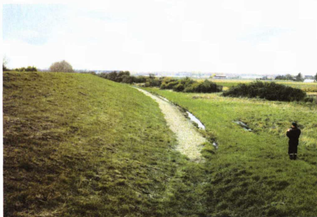
Photo 6 : Talus côté val renforcé sur la levée de Sandillon (45) - exutoire du tapis drainant.
